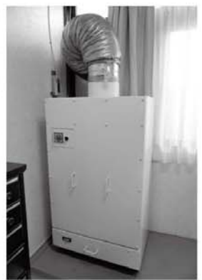
ワールドナースィングホームの簡易陰圧装置
